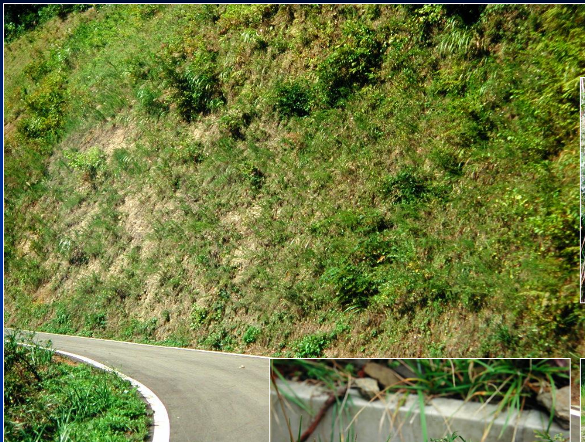
ヨモギの吹き付けが 施されたノリ面
